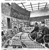
Пульт управления Ермаковской ГРЭС.
